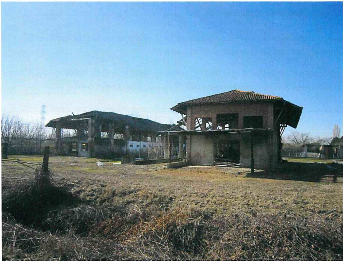
Vista del degrado degli immobili interni alle aree oggetto d'intervento
