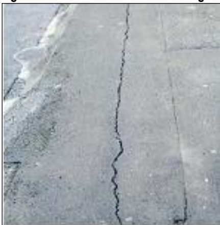
Figura 7: Schema di fessurazione longitudinale
