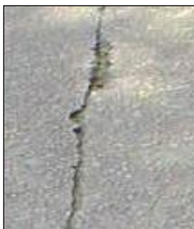
Figura 2: Esempio di fessurazione longitudinale
