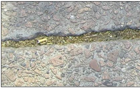
Figura 4: Degrado dei giunti non sigillati
