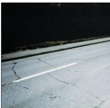
Figura 3: Esempio di fessurazione trasversale
