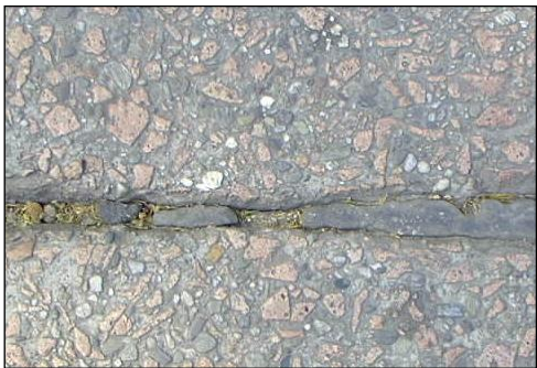
Figura 5: Degrado dei giunti precedentemente sigillati
