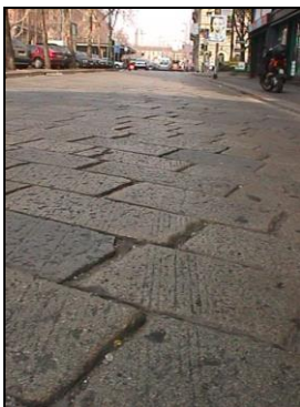
Figura 12: Eccessiva apertura dei giunti non sigillati
