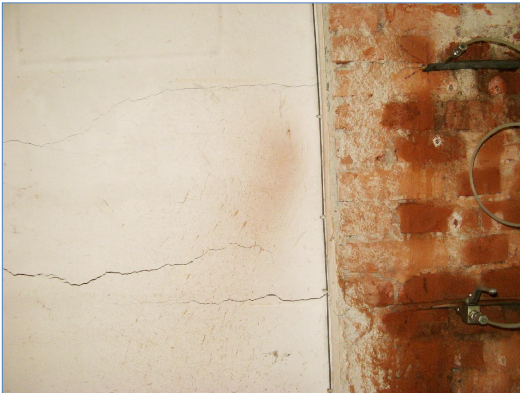
Fessurazioni parallele sub orizzontali sul muro di tamponamento in laterizio forato a fianco del setto murario pieno
