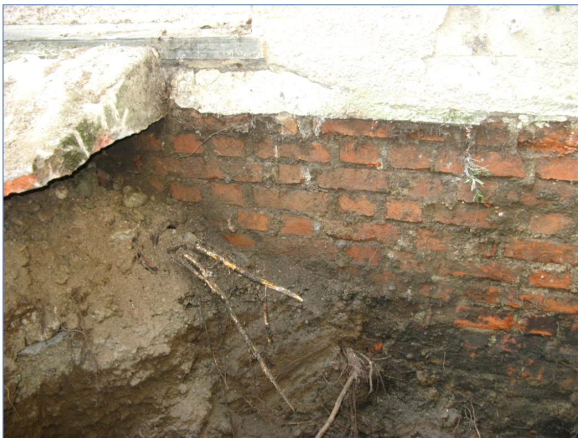
La muratura in mattoni pieni è continua su tutto lo sviluppo perimetrale del fabbricato.
